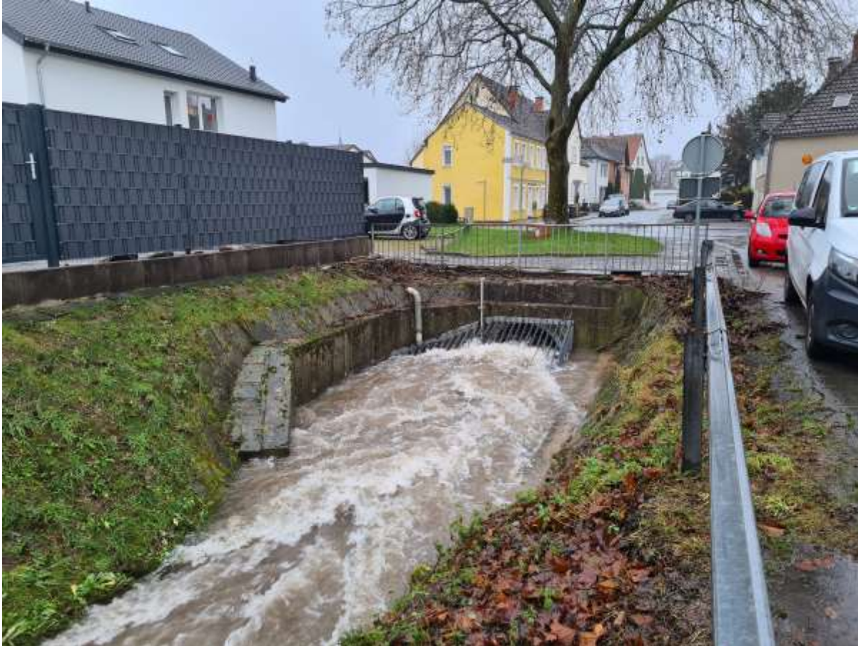
Hoppenberg, Einlaufrechen Verrohrung (Foto vom 25.12.23)
