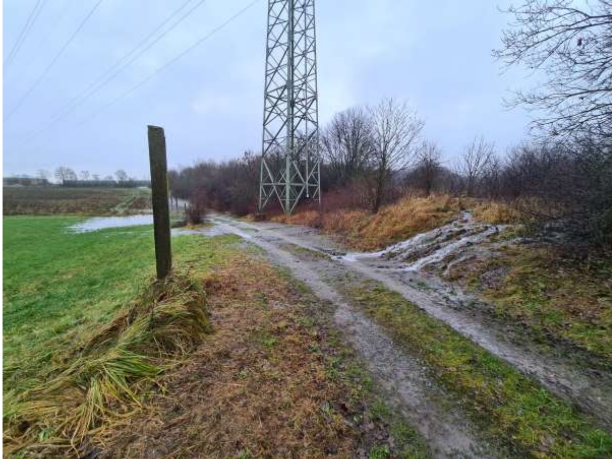
Hoppenberg, Einlaufrechen Verrohrung (Foto vom 25.12.23)
