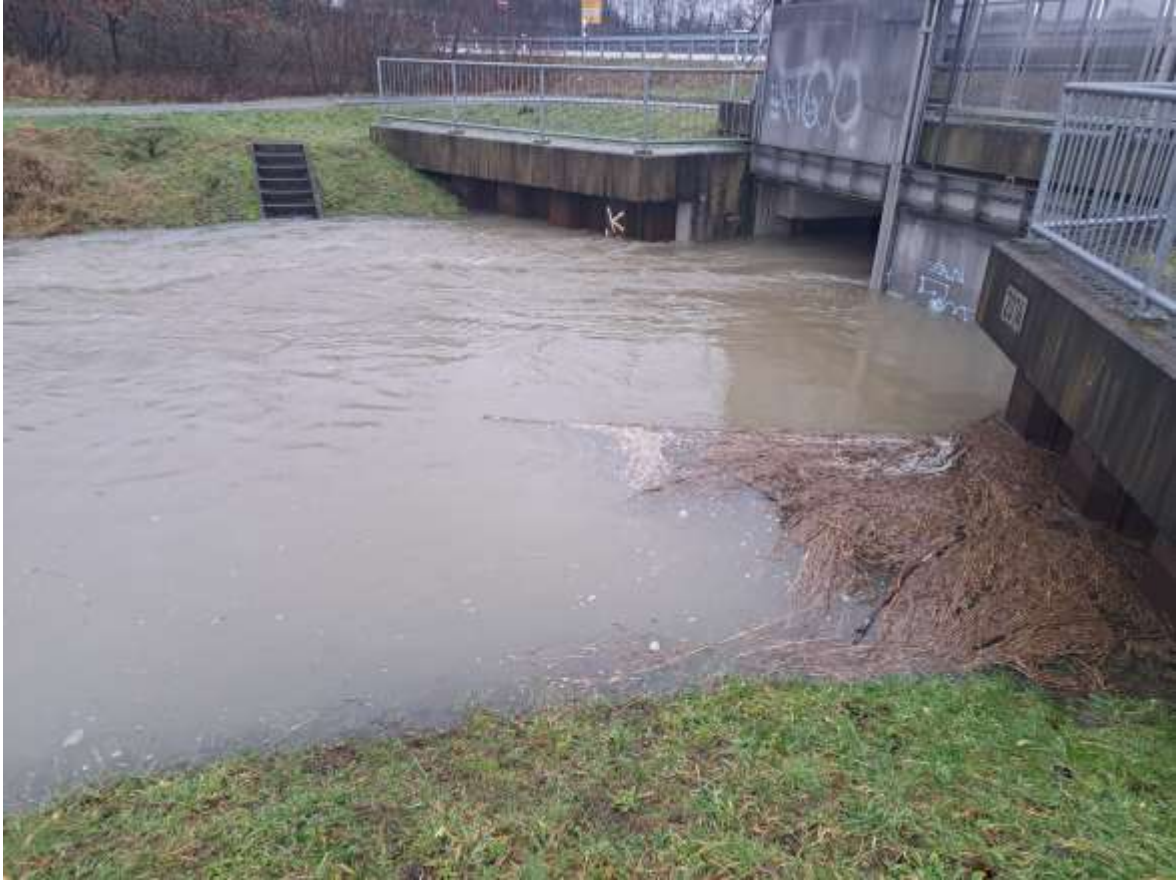
Lippe, Zuleitung Talleseen, Hubschütz an der B1 (Foto vom 25.12.23)
