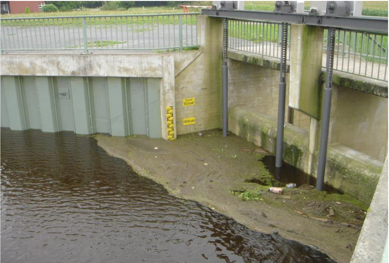
HRB Steinhorst Auslaufbauwerk
