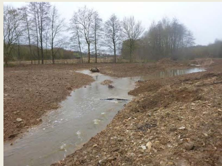
30.11.2015 Anschluss nicht durchströmter Bereiche
