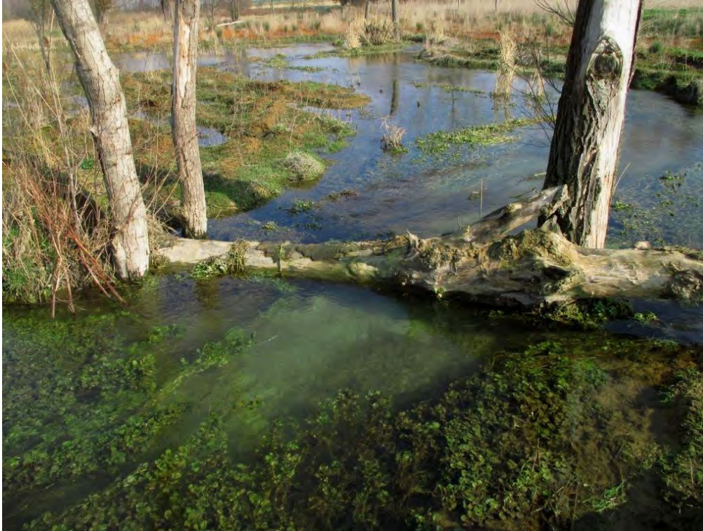
Abb. 68: Zur Initiierung eines Unterspülungskolks eingebauter und mit Weidensetzstangen gesicherter Baumstamm (29. Februar 2016).
