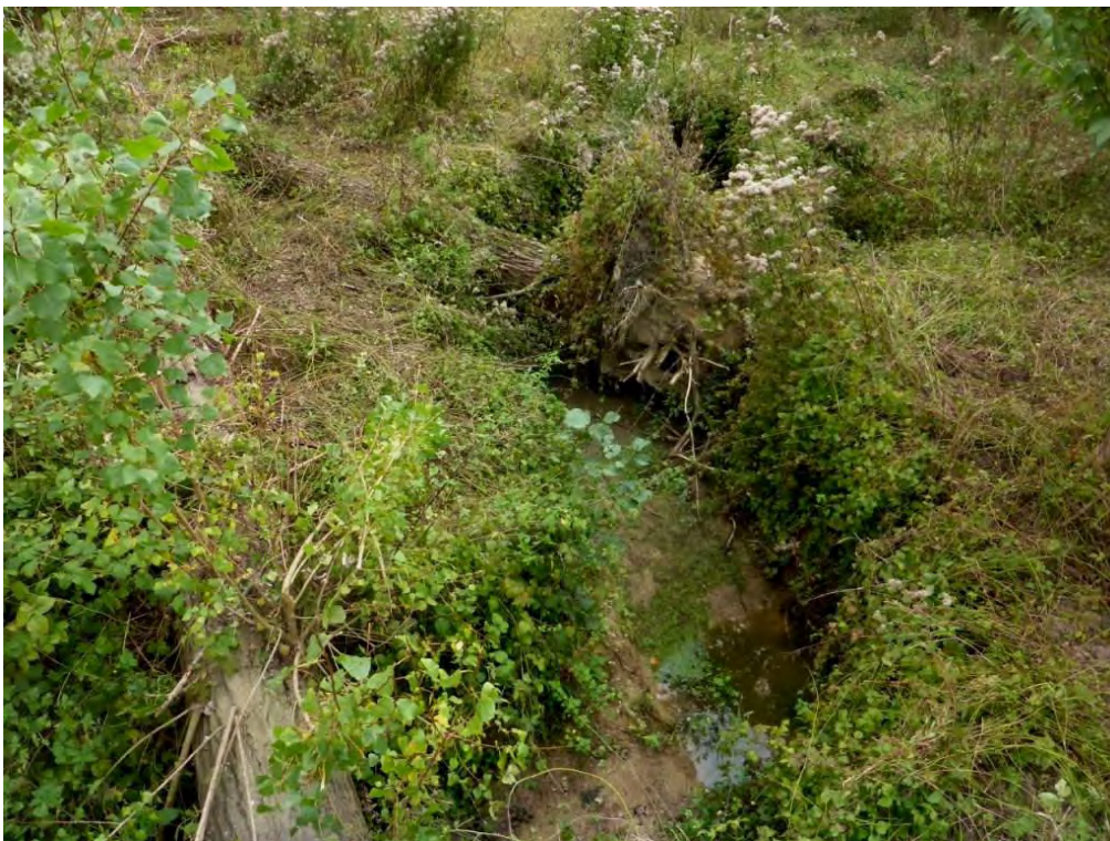
Abb. 6: Der Bach ist trocken gefallen. In den Restwasserpools an Krümmungskolken und Engstellen durch die Pappelwurzeln wimmelt es von Stichlingen. Die üppige Vegetationsentwicklung erschwert zunehmend die Einsehbarkeit (16. September 2016).
