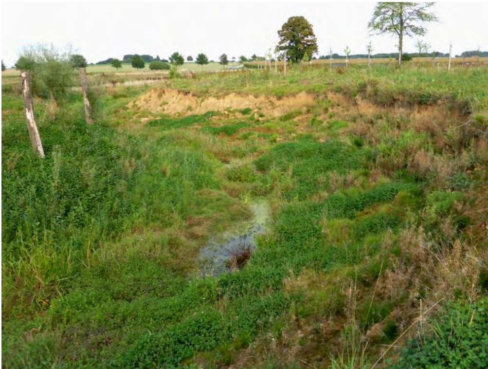
Abb. 34: Die Rutschungskeile am Böschungsfuß beider Seiten haben die Sohle auf etwa ein Drittel der ursprünglichen Breite verschmälert. Die Selbstbegrünung ist weit fortgeschritten. Das System stabilisiert sich (16. September 2016).
