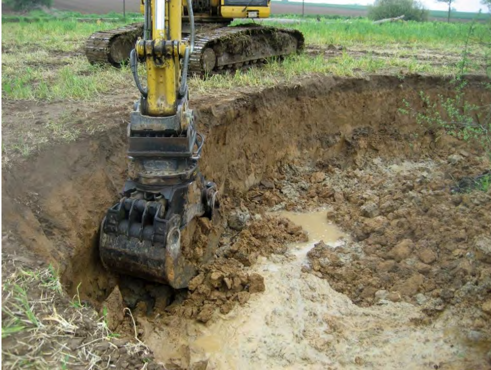
Abb. 11: Noch vor Flutung des neuen Verlaufes begannen die Steilwände nachzubrechen. Zur Wiederherstellung wurden die losen Erdschollen ausgebaggert (28. April 2014).
