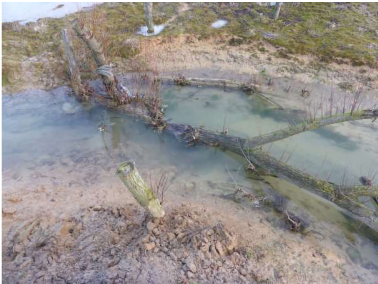
Kolkbildung durch Unterströmung von Baumstämmen
