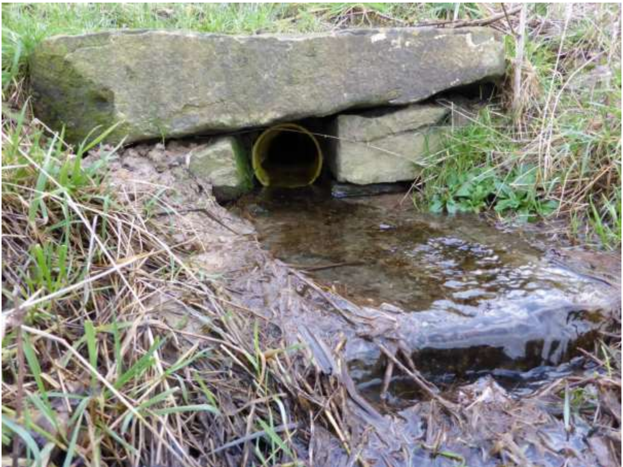
Auslaufbauwerke für Sammlermündungen aus wiederverwendeten Bruchsteinen
