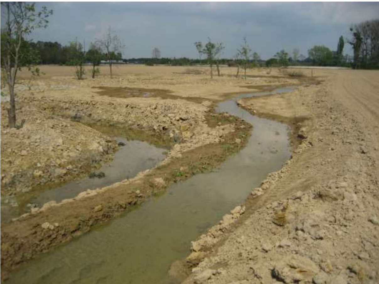
Zur Vernässung der Ersatzzue wurden einmündende Entwässerungsgräben parallel zum links tiefer liegenden Hauptgewässer geführt
